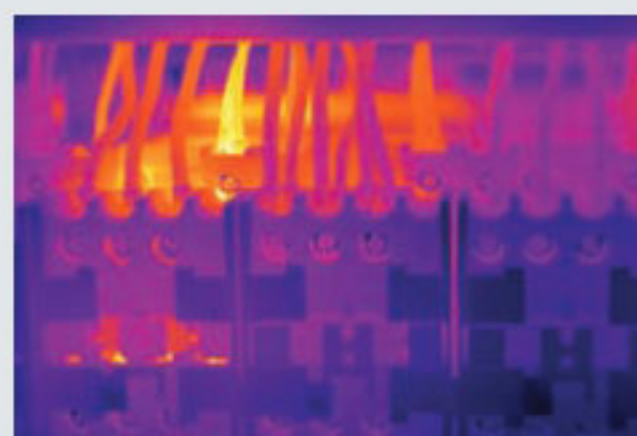
Диагностика электрических систем: Обнаружение аномально высокого нагрева автоматических выключателей и электрических компонентов до того, как произойдет поломка
